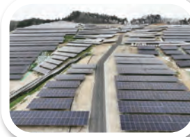
太陽光発電所 11.7MW （特別高圧：丸森町）
