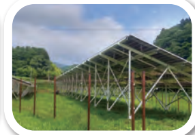
太陽光発電所 計1.3MW （低圧：15施設 角田市他）
