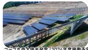
コープ丸森太陽光発電 (2024年度稼働予定)
